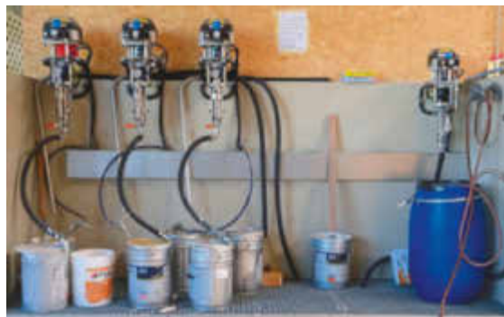
Platz für mehr: Bisher verrichten drei Pumpen in der Farbwechselstation ihren Dienst
