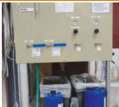
Saubere Sache: Wasseraufbereitungsanlage Waco 200 ...
