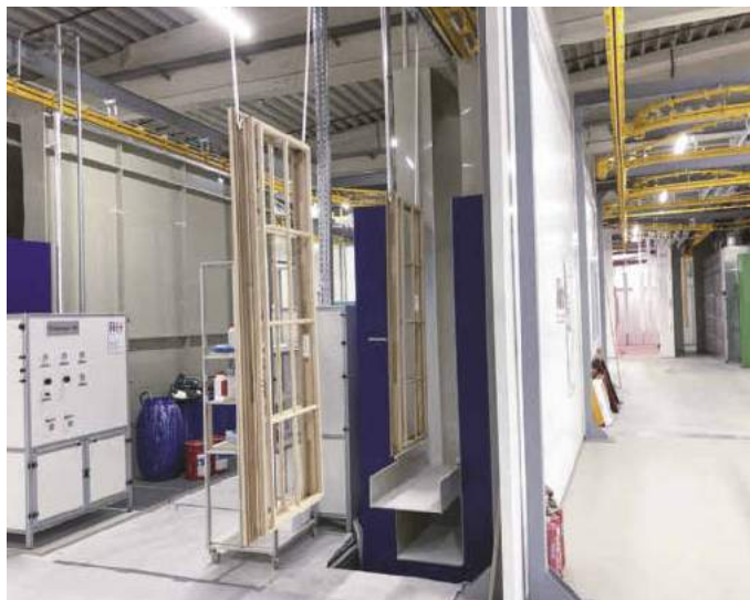
Neben der Flutanlage für lasierende Grundierungen steht eine weitere für deckende Aufbauten zur Verfügung
