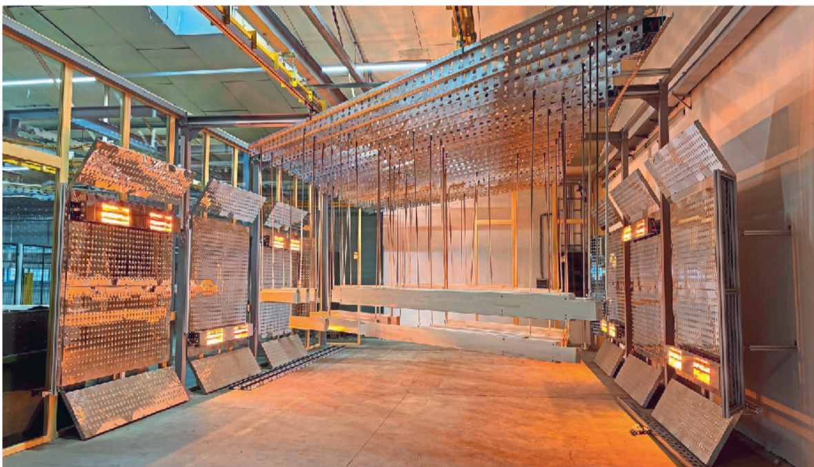
Bei den Range+Heine-Projekten profitiert der Kunde davon, dass die komplette Fördertechnik, Halogentrockner und Roboter aus einer Hand kommen.
