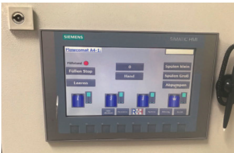
Die Flutanlage bietet einen halbautomatischen Farbwechsel für vier Farben. So stehen immer drei Lasurfarben und eine weiße Grundierung zur Verfügung.
