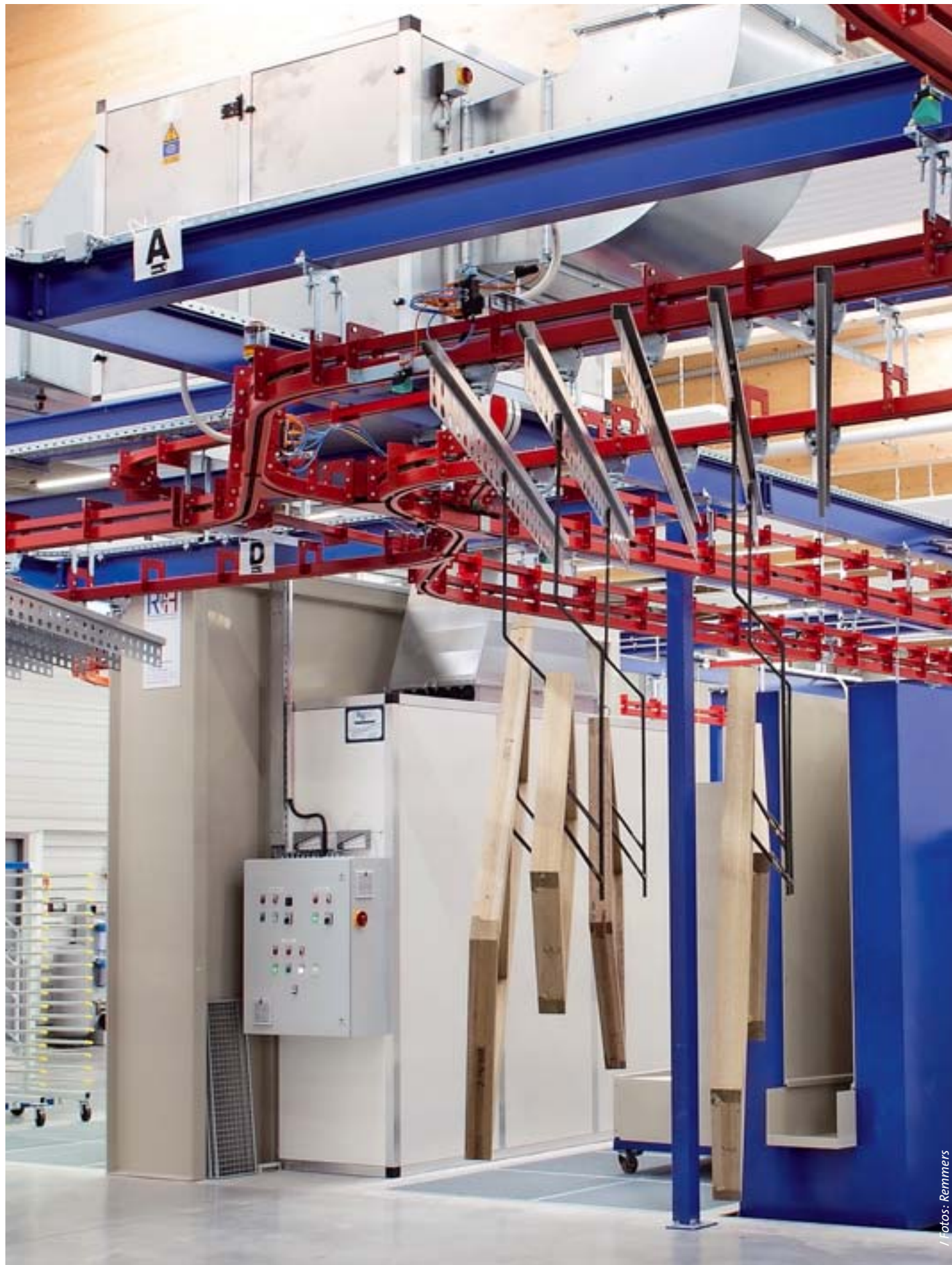
/ Das „Kompetenzzentrum Holzoberfläche“ von Remmers bietet mit moderner Anlagentechnologie die Möglichkeit, durch Realsimulation Anwendungen praxisnah nachzustellen. Hier zu sehen: Flutanlage „Flowcomat P“ von Range & Heine.
